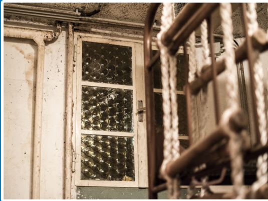
Der rustikale Notausstieg: Im Vordergrund die Strickleiter für den Fall der Fälle.
